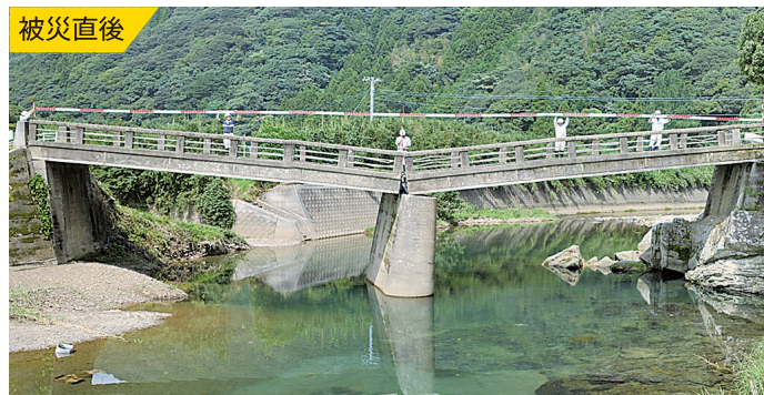
「通学橋」の災害復旧 [対馬市上県町 / 平成21年災害] (写真提供: 対馬市)
