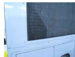
室外機の油にじみ
