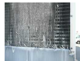
室外機の腐食
