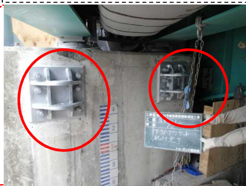
落橋防止装置(橋軸方向)
