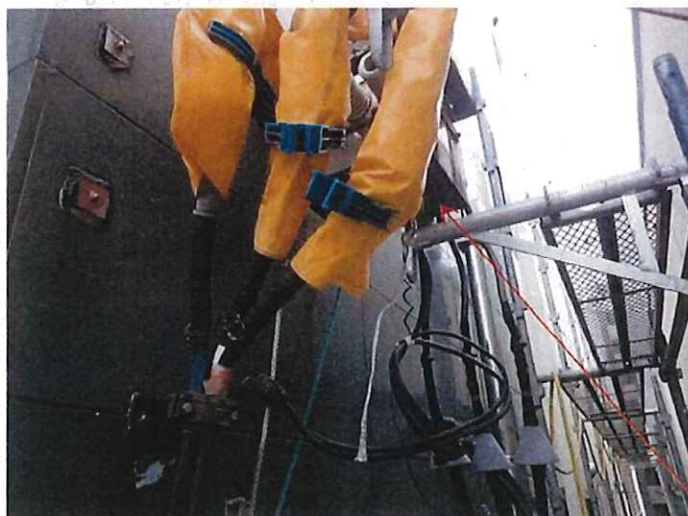
絶縁保護シートを取外した開閉器二次側
