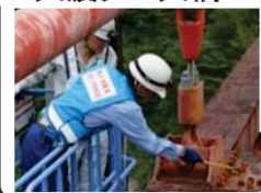
ケーブルの力 バー部の腐食
